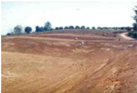
รูปที่ 3 การบดอัดดินในการสร้างสระน้ำในไร่นาเพื่อลดอัตราการไหลซึมของน้ำ (บริเวณสถานีพืชไร่ จ.เลย)
